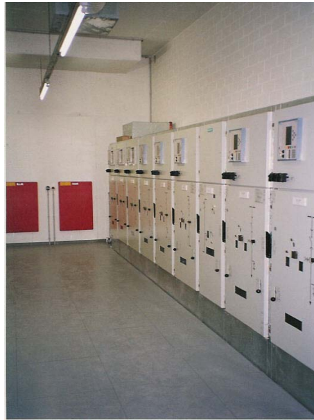
Bild 1: Mittelspannungsschaltanlage im Klinikum Erfurt
